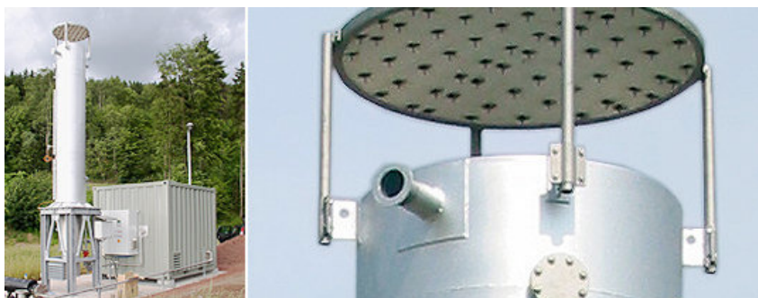
Figura 9-16: Stație de ventilare gaze și flacără de temperatură înaltă
