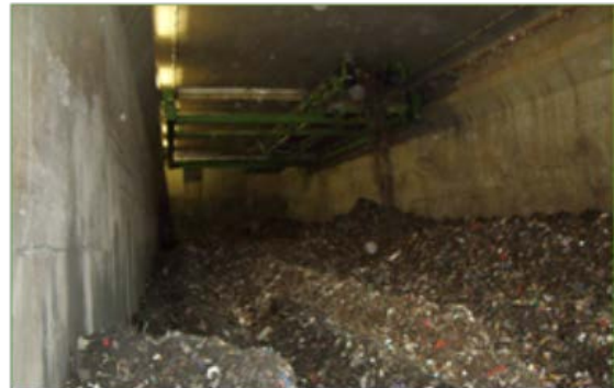
Interiorul tunelurilor de compostare
